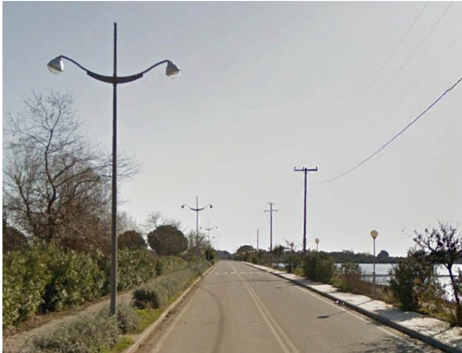
Εικόνα 8: Ιστοί φωτισμού στον Οικισμό Κουρούτας με λαμπτήρα τύπου CFL 23W (ύψος 3m) και με δύο λαμπτήρες τύπου Na 70W (ύψος 6m)
